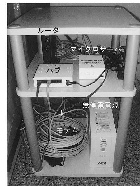
図2 宮崎県企業局岩瀬川水力発電所内(宮崎県都城市高城町)に設置した遠隔絶縁診断データ伝送システムに利用した機器の配置写真
